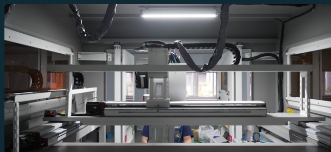
Оборудование на производственной площадке в Гуанси. Фото из материалов MDTS.
